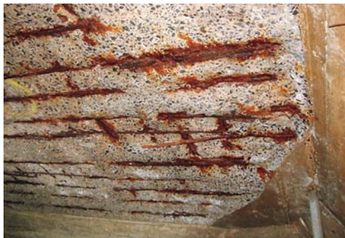
写真1 塩害で劣化した鉄筋コンクリート構造物
