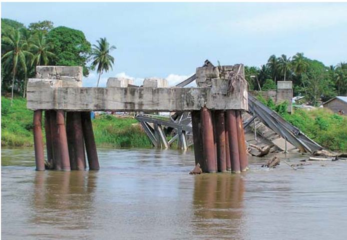
写真-1 津波による橋梁被害(桁流失)
